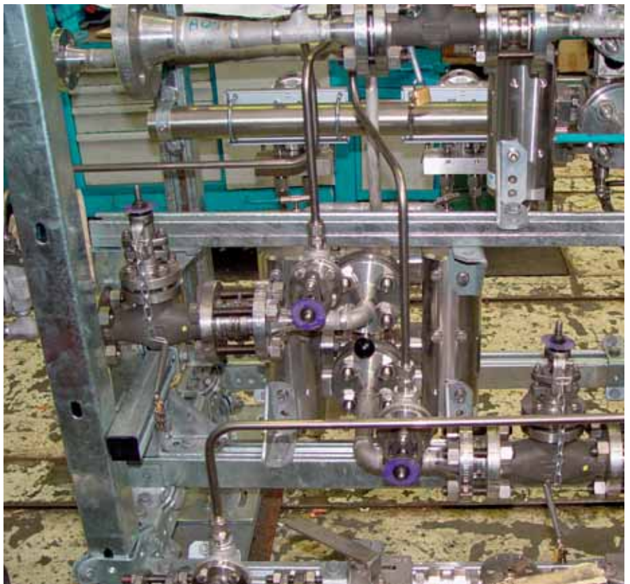
Komplexe Konstruktion für Anbindung von Armaturen und Leitungen auf engstem Raum Complex construction for connection of fittings, valves and pipes in a very confined space
